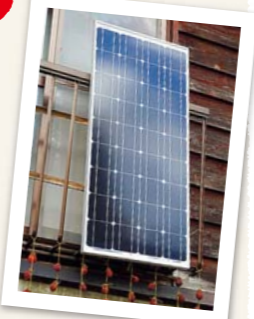
外壁に付けた1枚のソーラーパネルで電力を賄う
